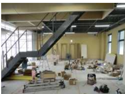
大阪事業所倉庫
