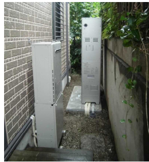
エネファーム設置後
