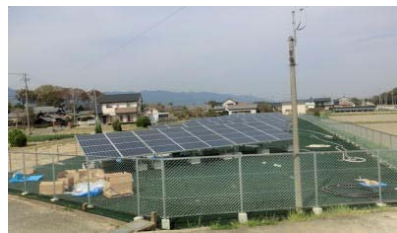
74.88KWシステム
