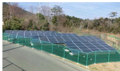
48.376 KWシステム
